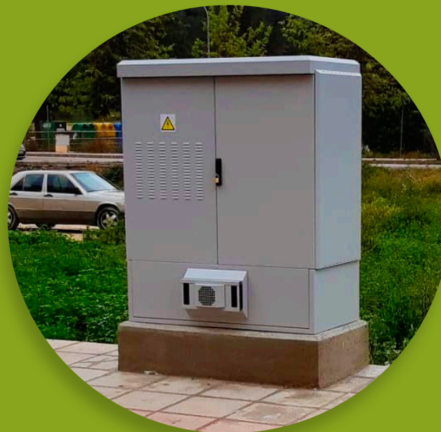
Gabinetes de exterior para celular y fibra óptica
