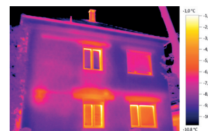
Imagen térmica con testo ScaleAssist
