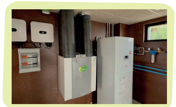
Sistema de Ventilación de la vivienda
